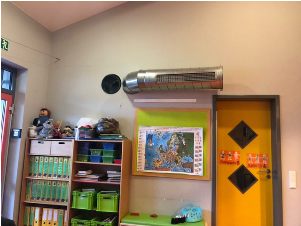
Ein Rohr und eine Fehlbohrung
