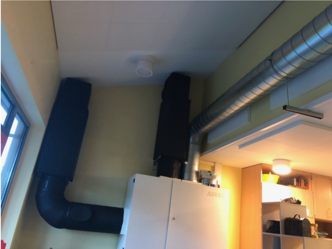
Ein Belüftungsungetüm und wenig Auslauf für Frösche
